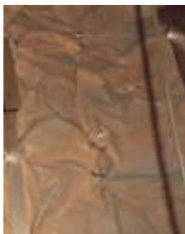
Figura 27 – Dobras provenientes na movimentação e pontos de corros o (foto: Geisa Alchorne, 2011)
