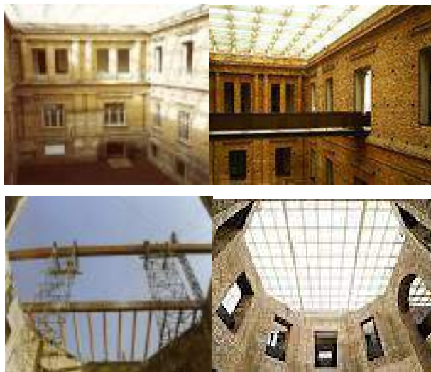
Figura 32 – Vista do pátio e da cobertura antes/ depois da reforma Pinacoteca/ Estado de São Paulo (Fonte: ARAUJO, 2002, p.60-79)
